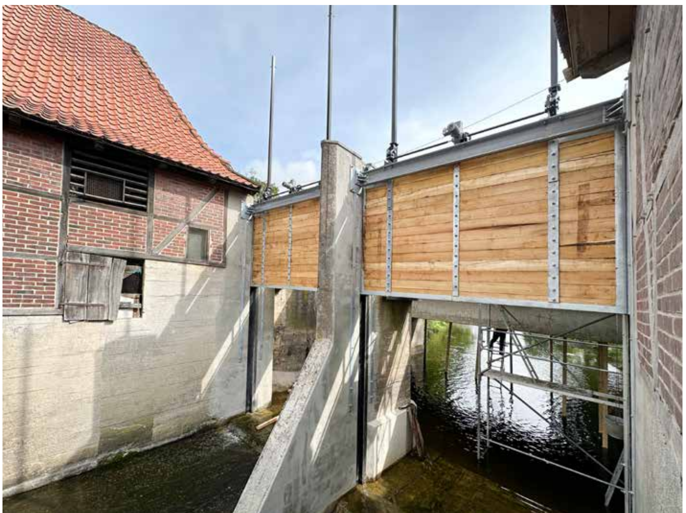
Eingesetzte Wehrtafeln an der Füchtelner Mühle (Foto: WBC)
